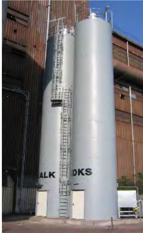
Silo carbone e silo calcare
